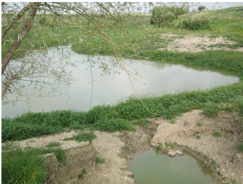
Foto 5 – lacul de acumulare pe valea Rada și barajul avariata
